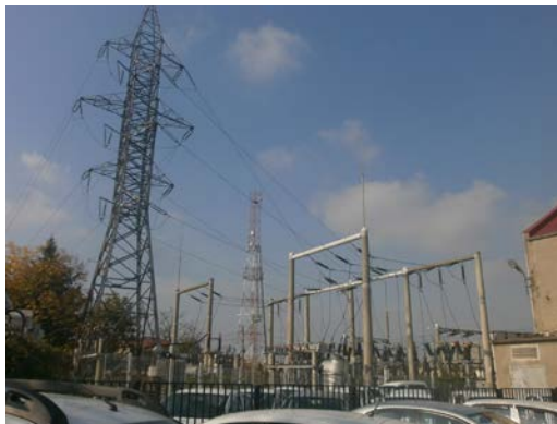
Fotografie actuală a Stației Iași Centru prin care s-a realizat, la 27.12.1957 , racordarea Uzinei la 110 KV.
