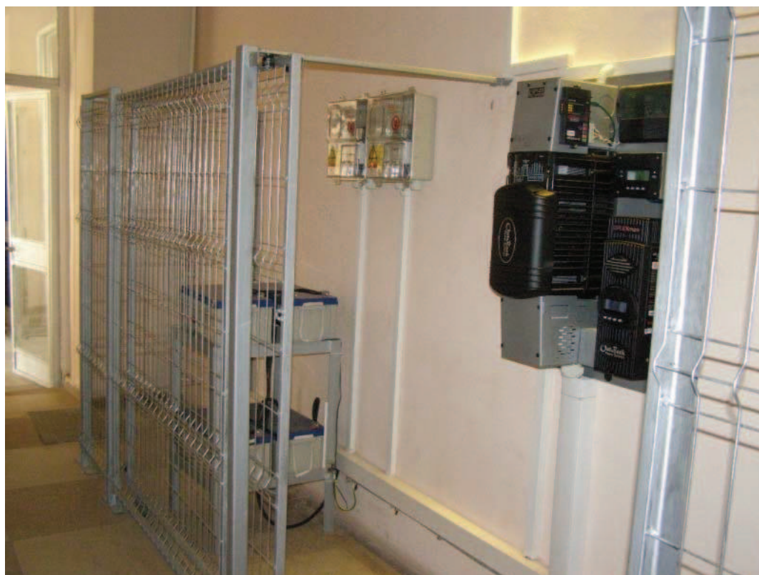
Fig. 6. Imagine parțială a instalației de interior a sistemului fotovoltaice
