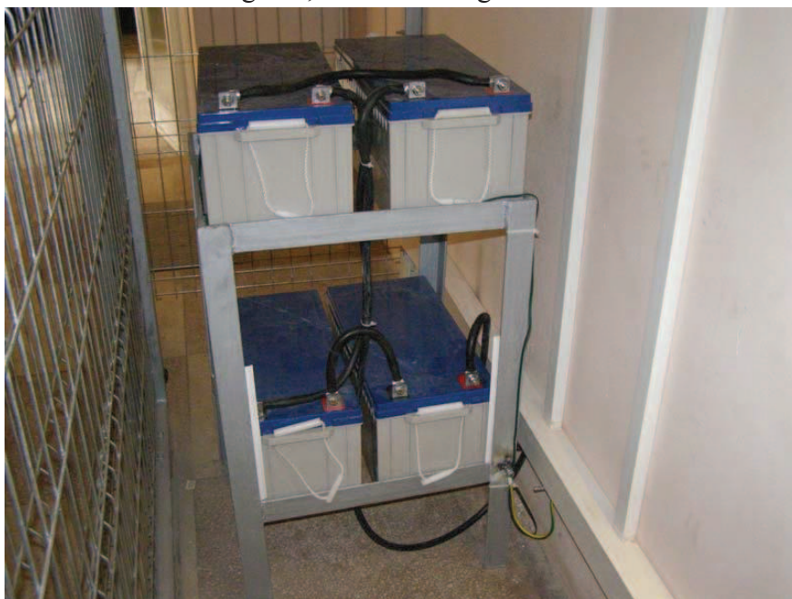
Fig. 4. Imagine de detaliu a bateriei de acumulatori a sistemului fotovoltaic
